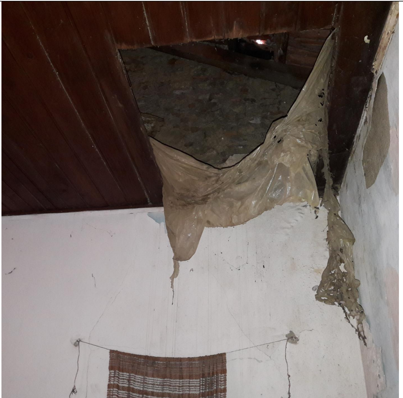
FOTO 6 : cattivo stato di manutenzione copertura
