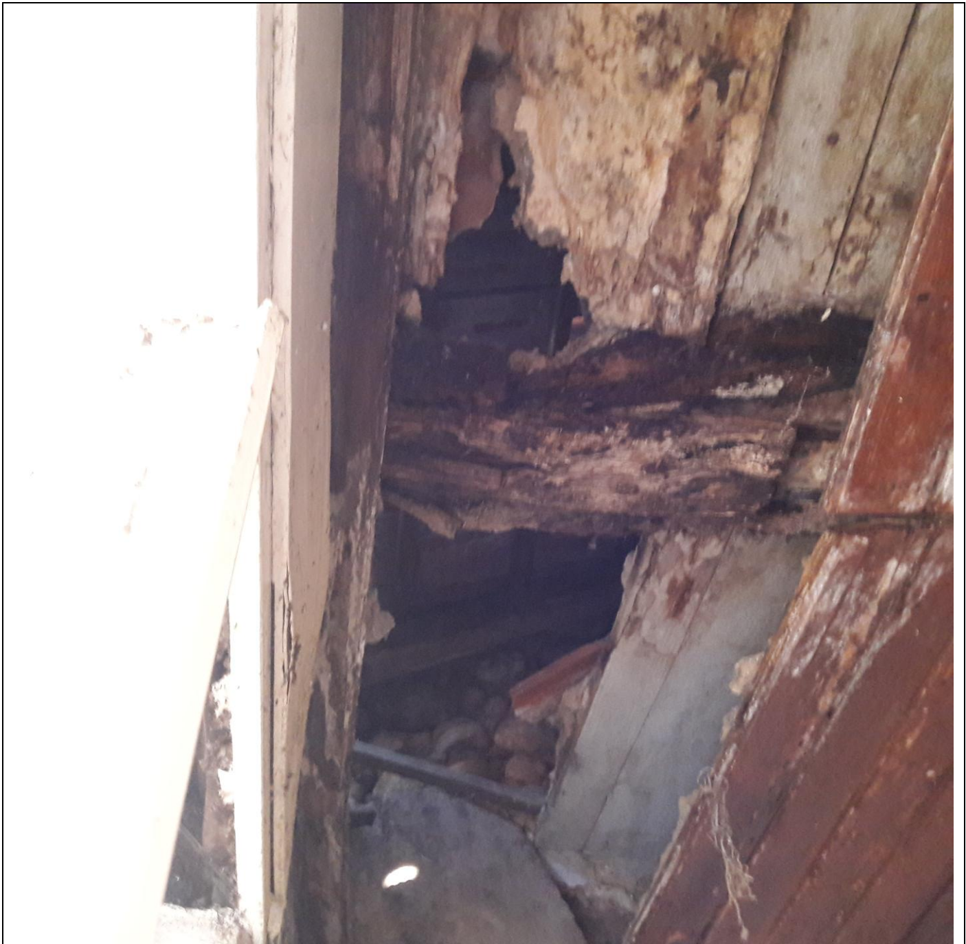
FOTO 5 : marcescenza travetti in legno solaio di sottotetto
