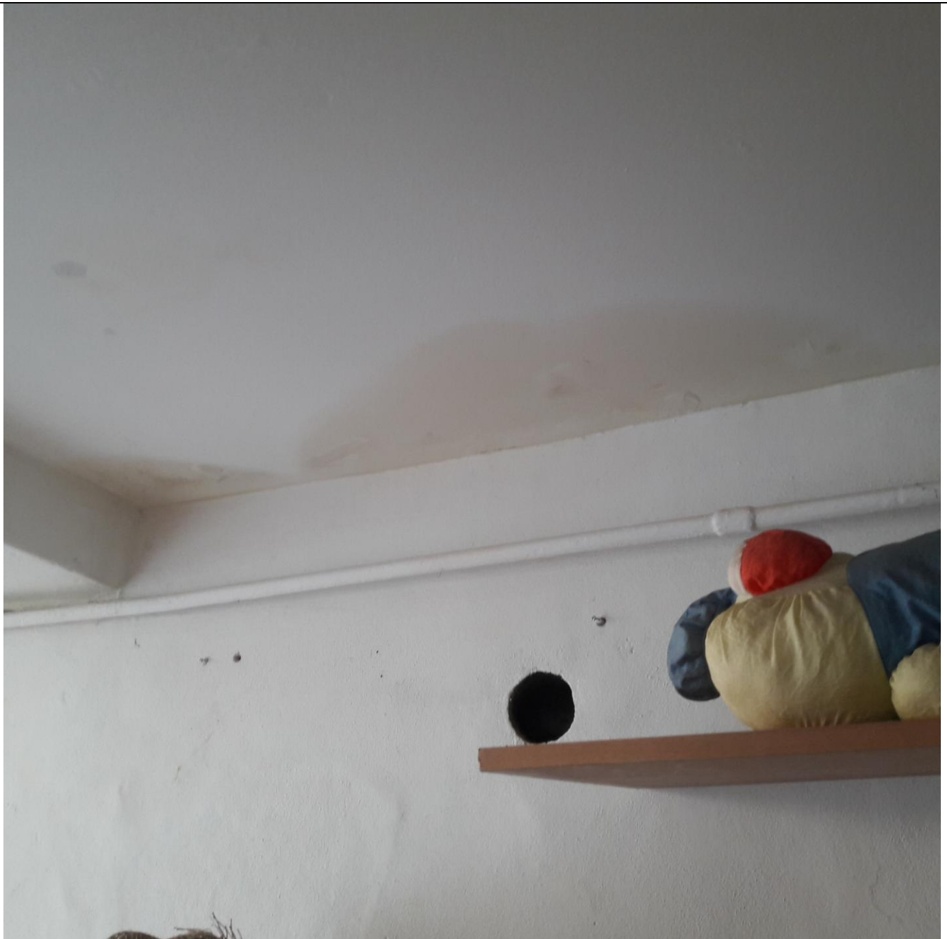
FOTO 4 : infiltrazione d'acqua sino a solaio tra piano terra e piano primo
