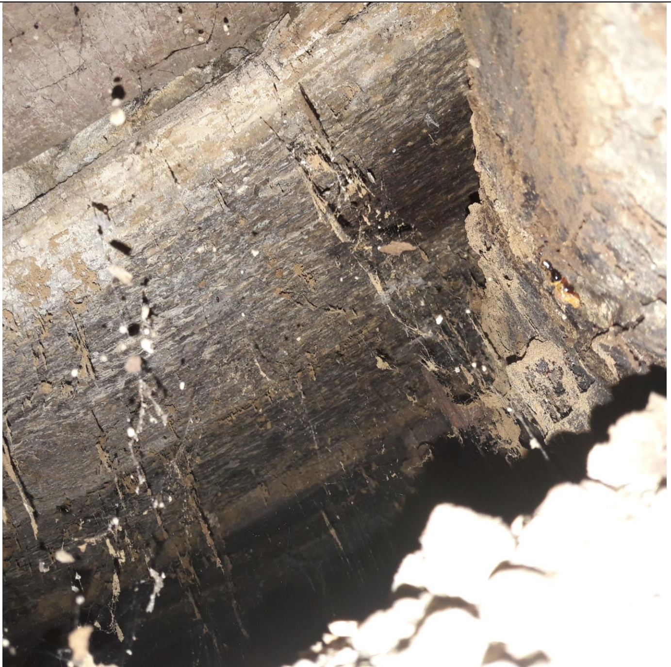
FOTO 3 : ammaloramento solaio ligneo tra piano terra e piano primo
