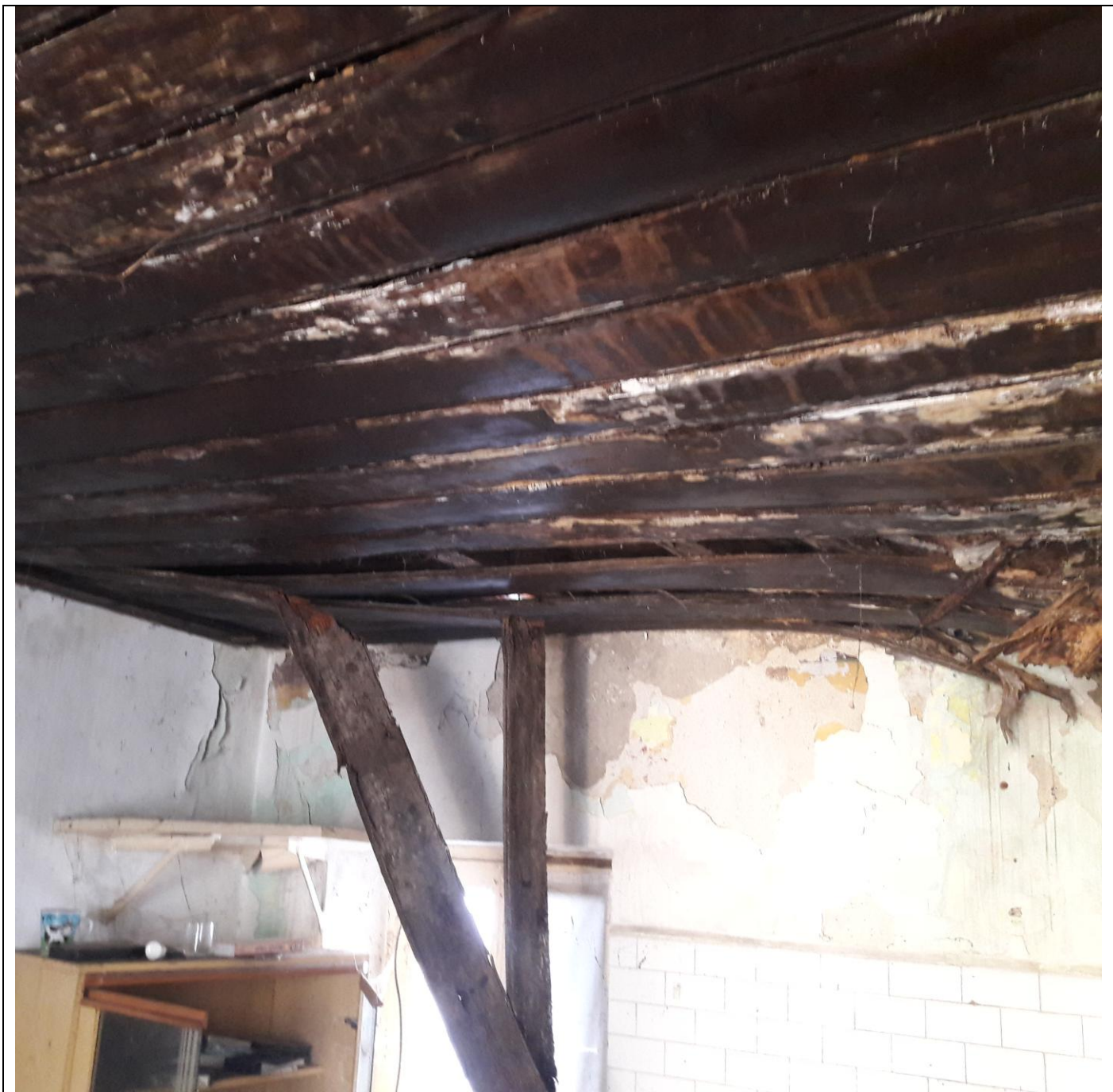
FOTO 7 : marcescenza solaio in legno di sottotetto - infiltrazioni d'acqua
